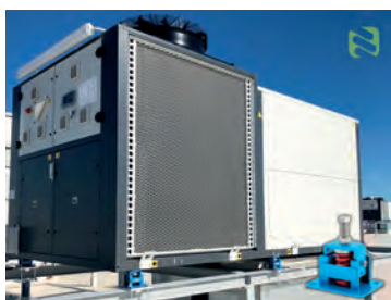
Soleco. Supporti Antivibranti installati sotto unità HVAC
